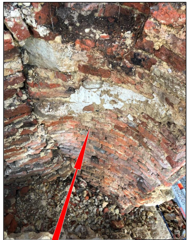
De ronding van de spiltrap, met enkele resten van de uitgebroken treden in de wand.
