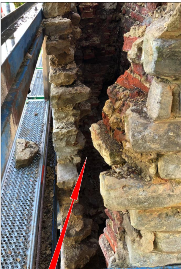
De holle noorderwand, plaats van een uitgebroken spiltrap.
