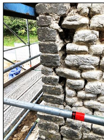
Werffoto: brandschade op gobertangestenen.
